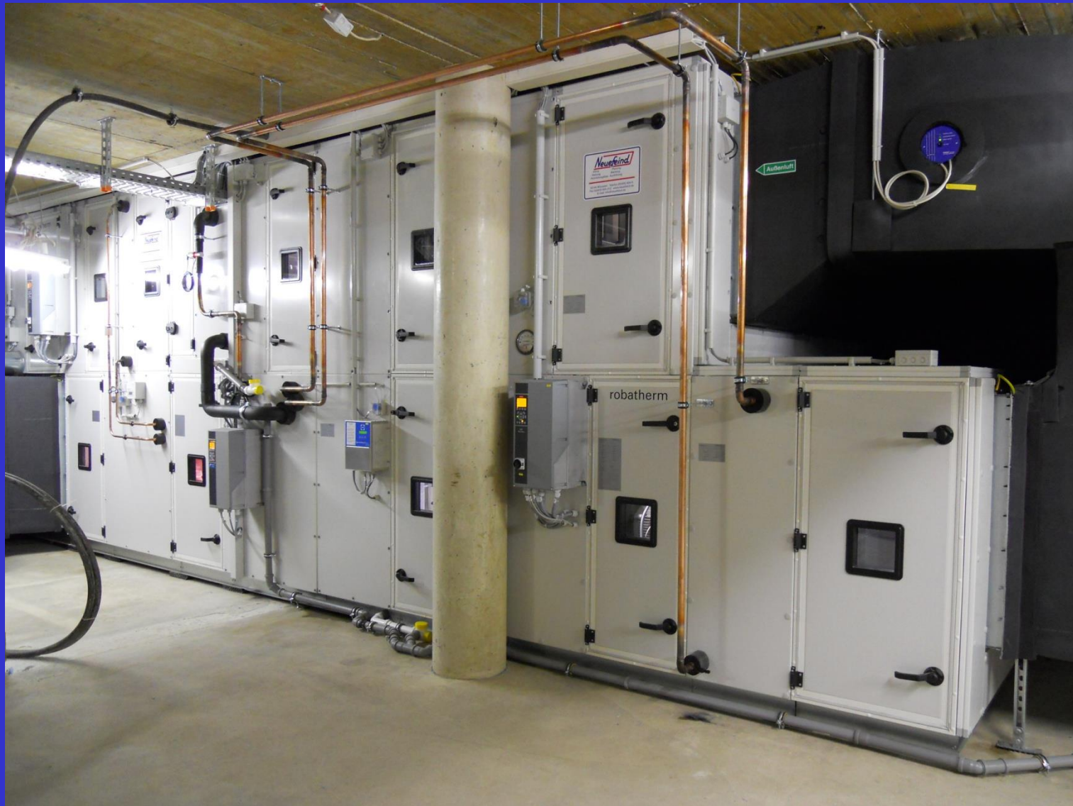
Schatzkammer Neue Klimaanlage 2012 – 18°, 55%
