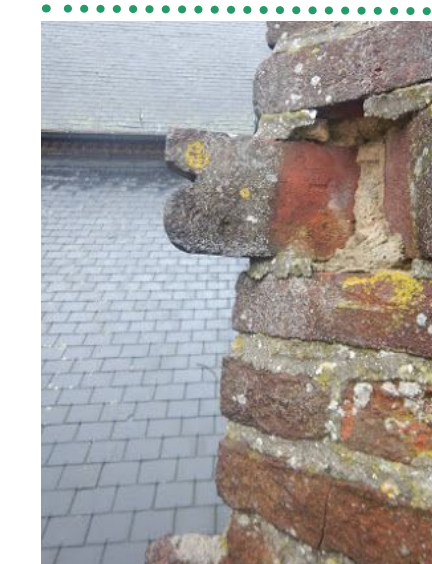
Verweerd & uitgespoeld metselwerk
