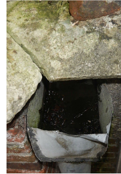
Dak [9]: vervuilde vergaarbak.
