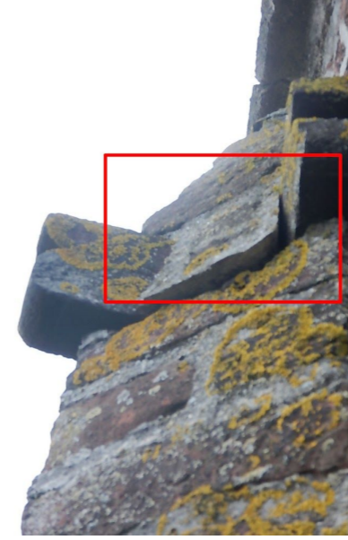
Verweerd en uitgespoeld metselwerk.
