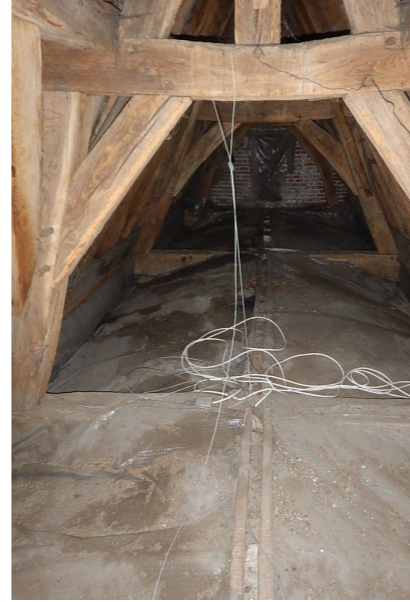
Dak [3]: onveilig toegankelijke zolders.
