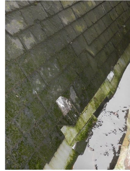
Dak [9]: uitgeschoven en niet-duurzaam herstelde leien.
