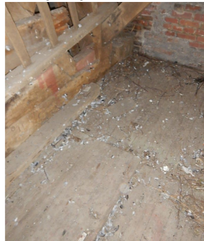
Vervuiling in de toren.
