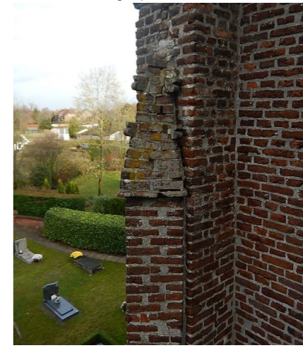
Verweerd en uitgespoeld metselwerk.
