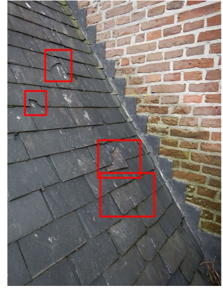
Dak [9]: gebroken, uitgeschoven en herstelde leien.
