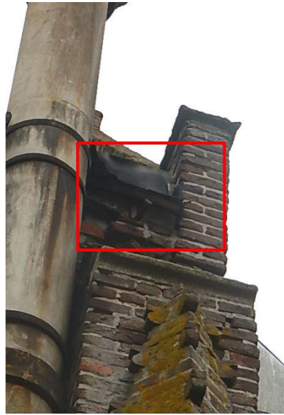
Dak [4]-oost: weggefallen hanggoot.
