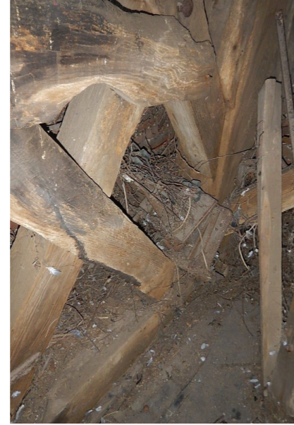
Vervuiling rond de klokkenstoel.
