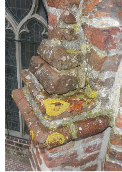
Verweerd en uitgespoeld metselwerk.
