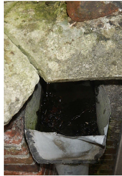
Dak [9]: verweerde vergaarbak.
