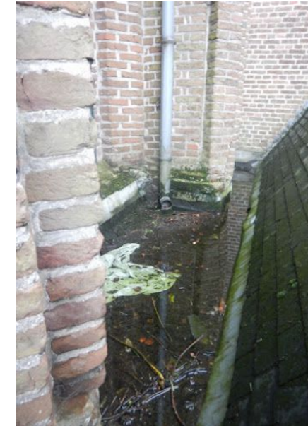
Dak [9]: vervuilde zakgoot.
