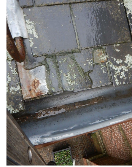
Dak [8]: herstelling met elastische voegkit.
