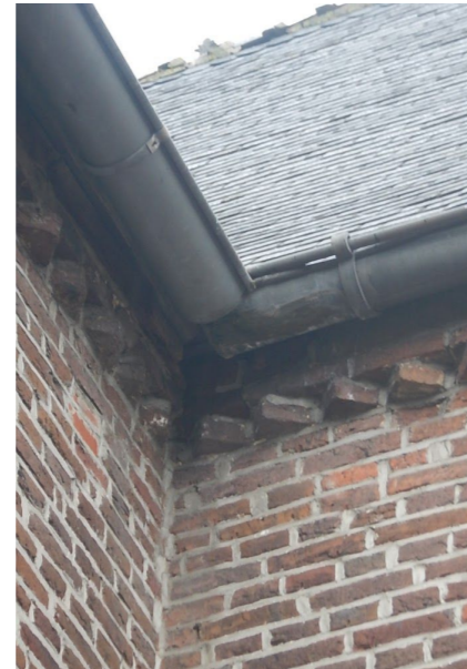
Lek in goot dak [4] en [5].
