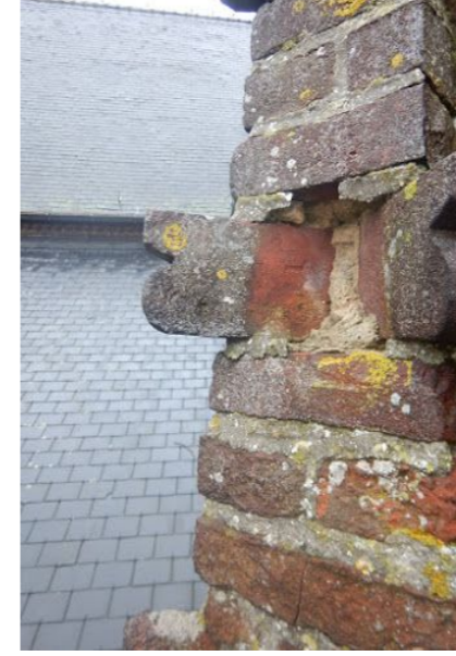
Verweerd en uitgespoeld metselwerk.
