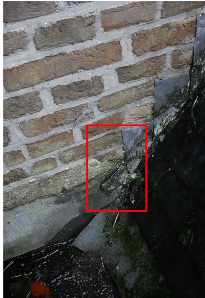
Dak [9]: ontbrekende loodslab.
