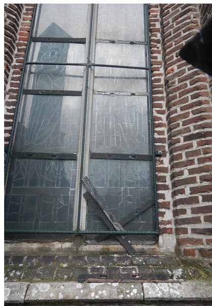
Weggevalen losse raambruggen.
