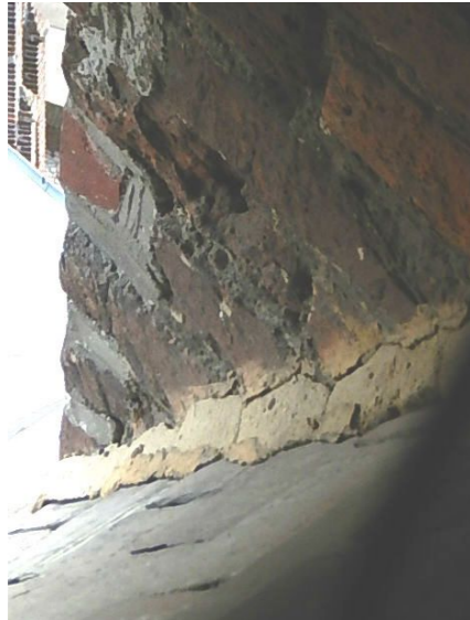
Galmbord: losgebroken mortelzoom.
