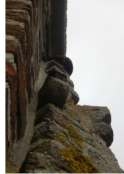
Verweerd en uitgespoeld metselwerk.
