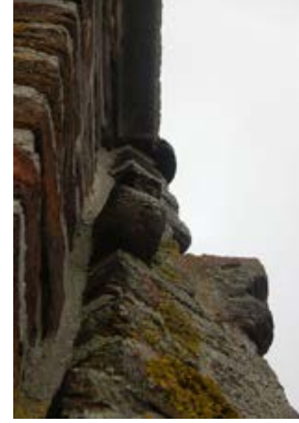
Verweerd en uitgespoeld metselwerk.
