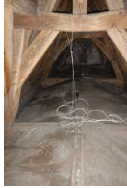
Dak [3]: onveilig toegankelijke zolders.
