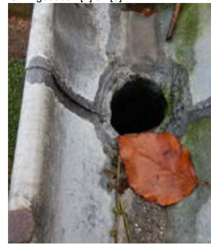
Dak [8]: gescheurde soldeernaad.
