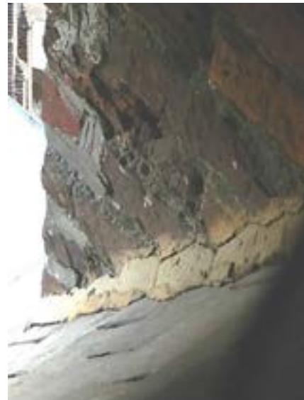
Galmbord: losgebroken mortelzoom.
