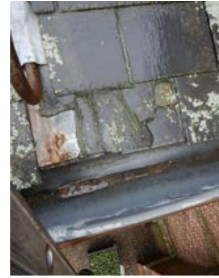
Dak [8]: herstelling met elastische voegkit.
