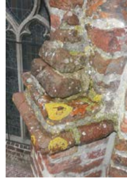
Verweerd en uitgespoeld metselwerk.
