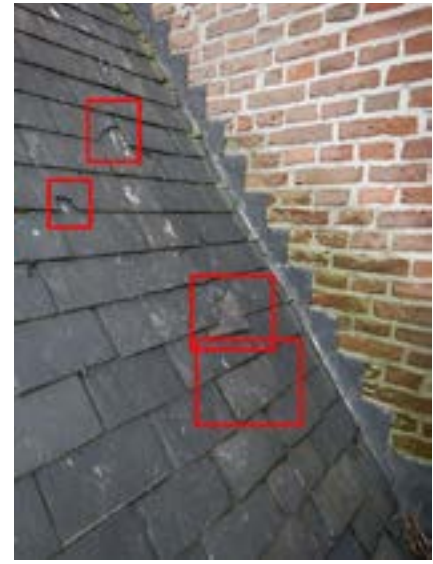
Dak [9]: gebroken, uitgeschoven en herstelde leien.
