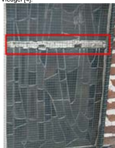
Weggefallen losse raambrug.
