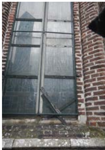
Weggefallen losse raambruggen.
