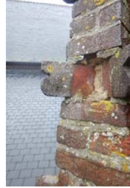
Verweerd en uitgespoeld metselwerk.
