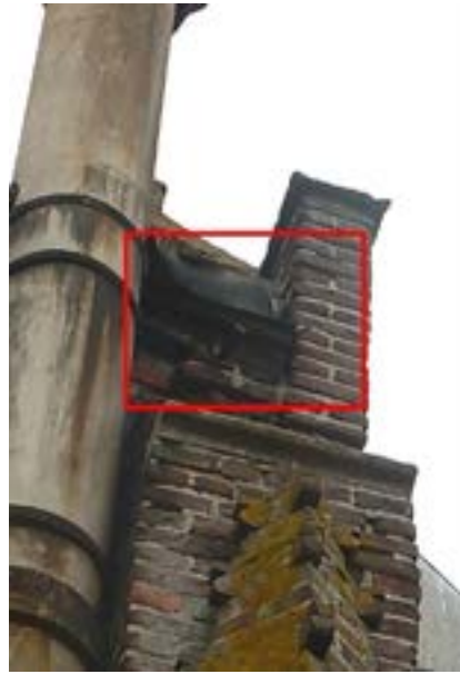
Dak [4]-oost: weggefallen hanggoot.
