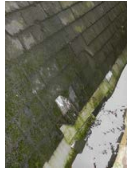
Dak [9]: uitgeschoven en niet-duurzaam herstelde leien.
