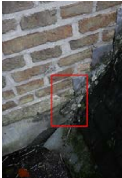
Dak [9]: ontbrekende loodslab.
