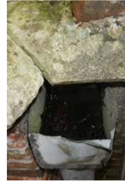
Dak [9]: vervuilde vergaarbak.
