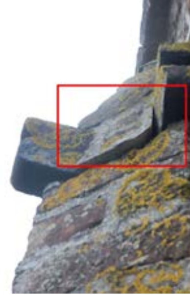
Verweerd en uitgespoeld metselwerk.
