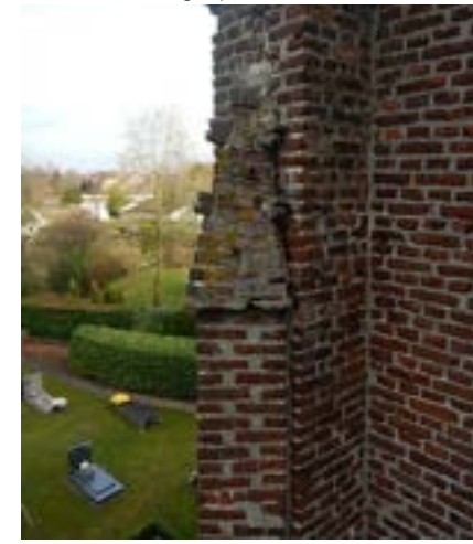
Verweerd en uitgespoeld metselwerk.
