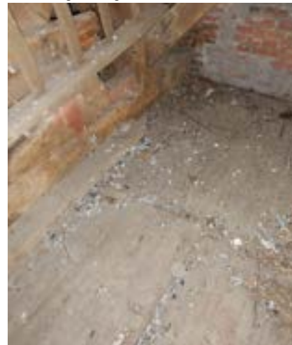
Vervuiling in de toren.
