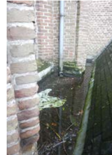
Dak [9]: vervuilde zakgoot.
