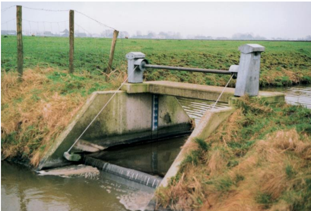
Klepstuw, bediening met kabels
