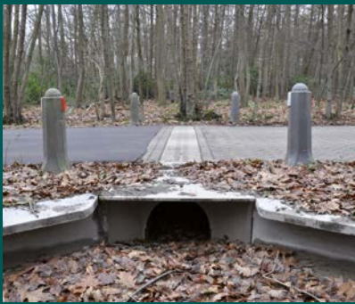
Figuur 2: Amfibieëntunnel onder de weg met geleidingswand © Lotte Gielis
