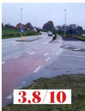
Het fietspad langs de Steenweg op Veerle, hier op de kruising met de Oude Veerlebaan, is dringend aan een opknappbeurt toe.
